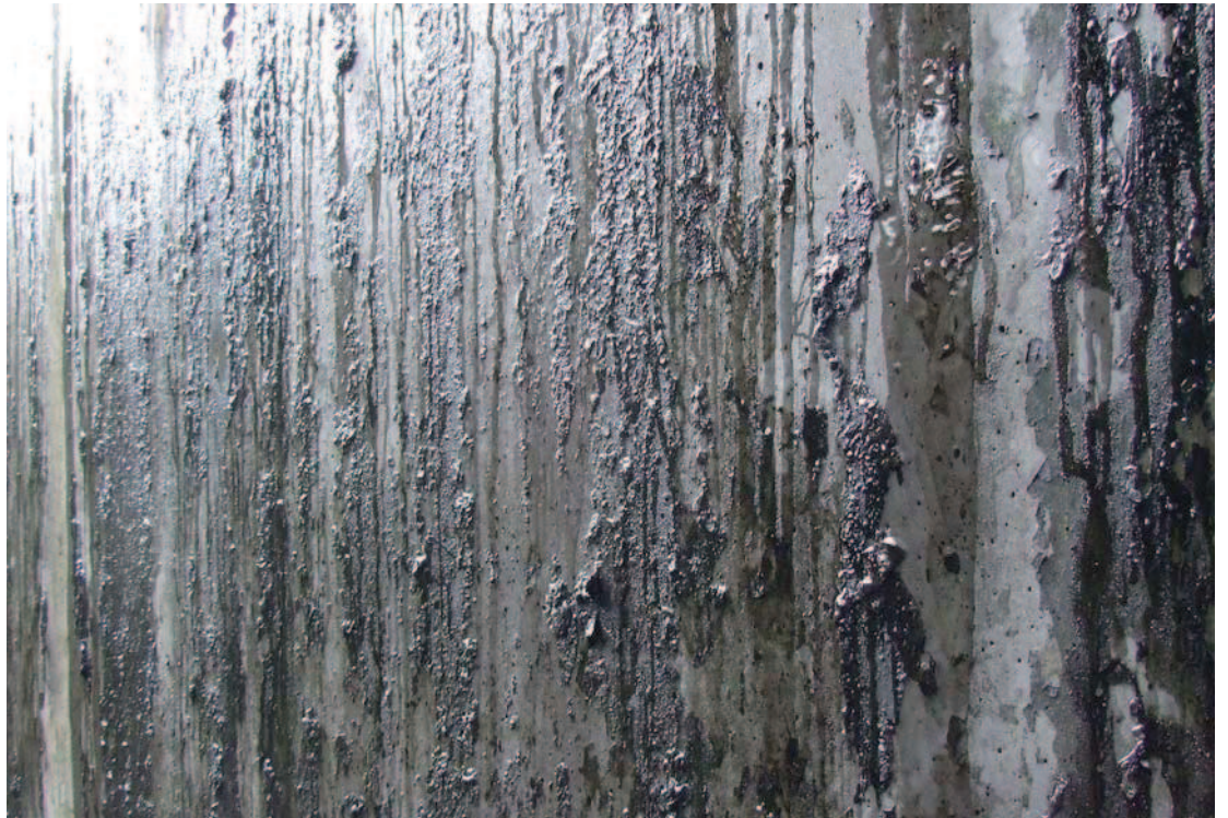
la texture inquiétante d'une face de béton photo: groupe
